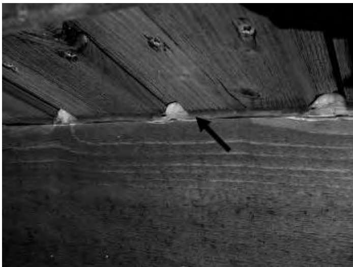
Bild 14: Mangelhafte Fugendimensionierung am Anschluss der Nut- und Federbretter zum unteren Holzbalkenabschluss (nicht maßhaltige Bauteile im Außenbereich dürfen nicht mit spritzbaren Dichtstoffen abgedichtet werden)
