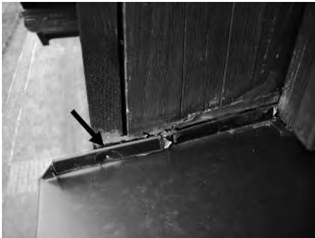
Bild 16: Kohäsionsrisse im Dichtstoff zwischen Metallprofil und Holzwand aufgrund zu starker Fugenbewegung
